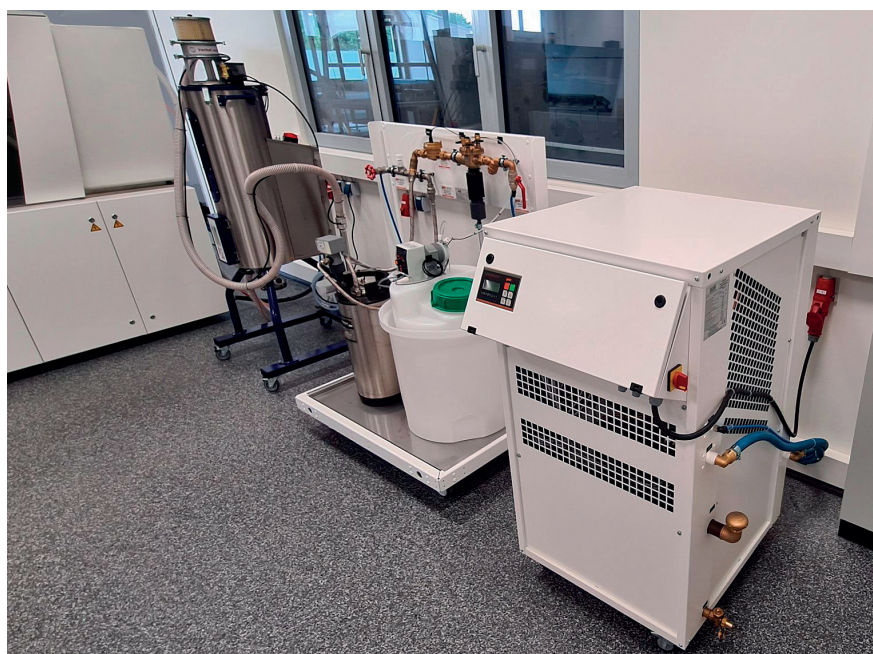
Bild 3: Im neuen SIT in Lüdenscheid ist ein kompletter Spritzgieß-Prozess mit ENGEL-Spritzgießmaschine, Z-System sowie Werkzeug-Vorrichtungen, Kühlwasser-Aufbereitung und Materialtrocknungsanlage von WENZ installiert
